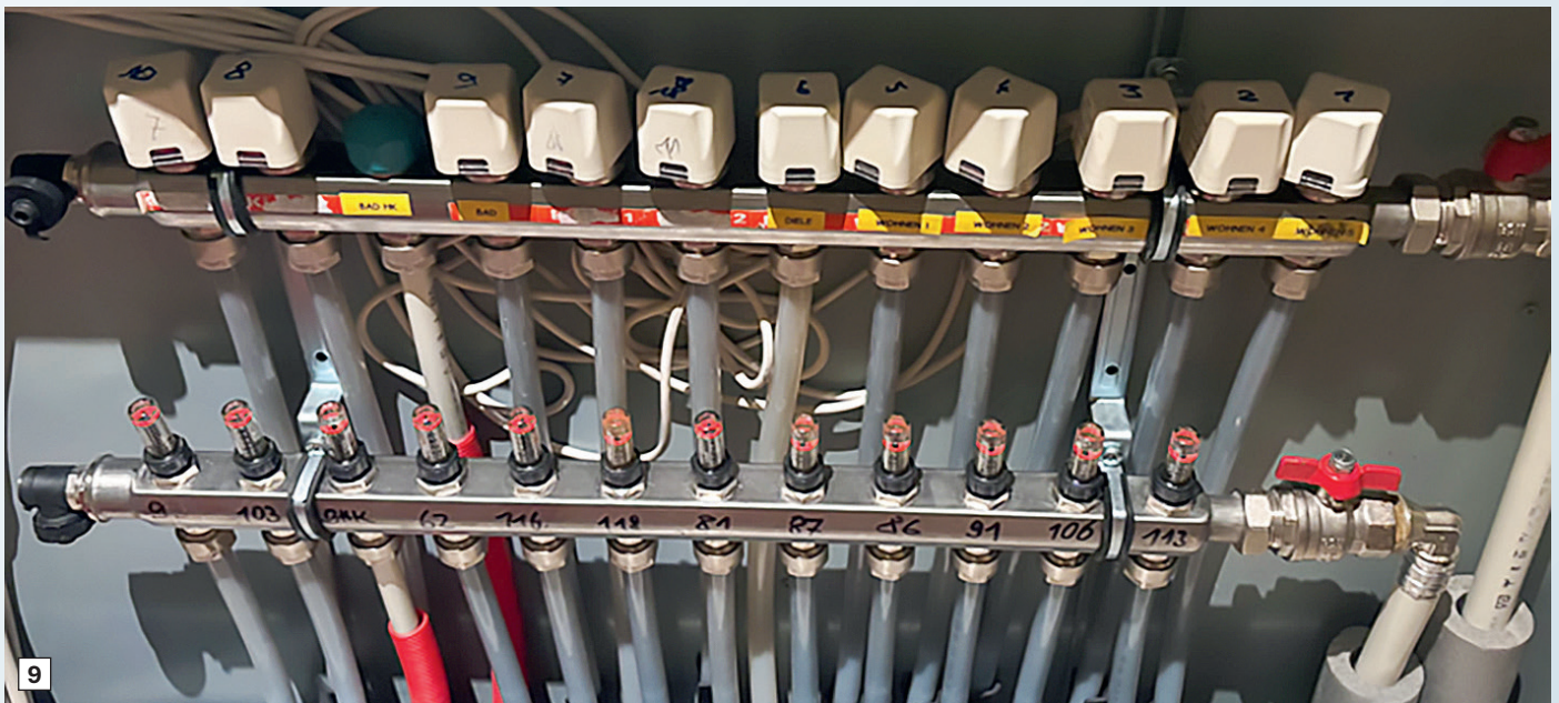
9 Fußbodenheizungsverteiler mit thermischen Stellantrieben.
